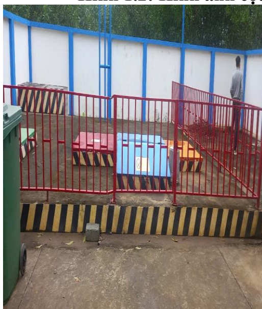
Hình 1.3: Hình ảnh bể chứa xăng dầu
