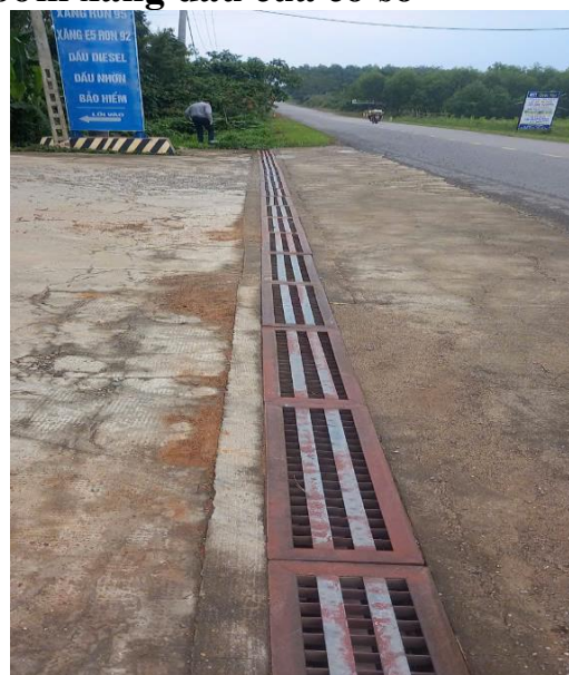
Hình 1.4: Rãnh thu gom nước mưa nhiễm xăng dầu
